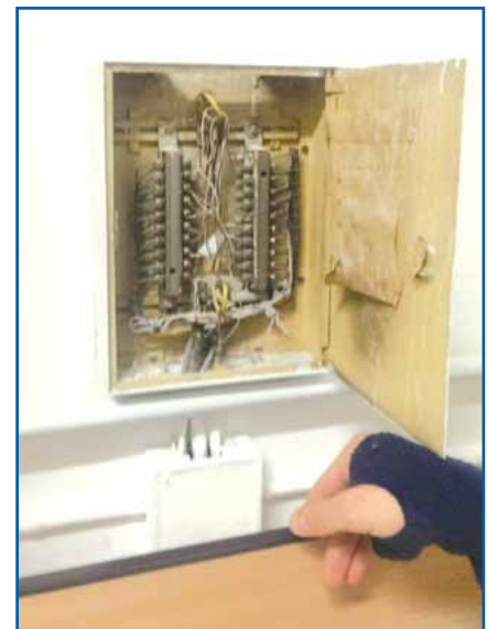
Nicht gesicherter, geöffneter Stromverteilerkasten
