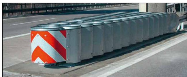
Anpralldämpfer VECU-STOP® dauerhaft installiert
