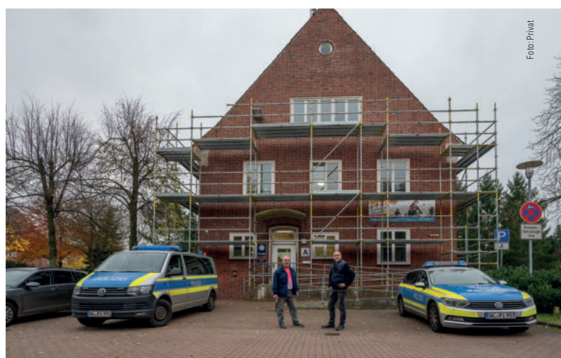
Bereits seit längerem wird das ESD-Gebäude von einem Baugerüst „geschmückt“. Davon: Hans-Ulrich Koch und Uwe Hesebeck.
