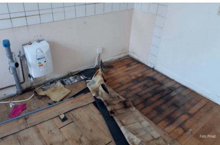
Der Wassereintrich in der Küche sorgte für starke Geruchsemissionen. In der Vergangenheit mussten Beschäftigte immer wieder Einschränkungen hinnehmen.
