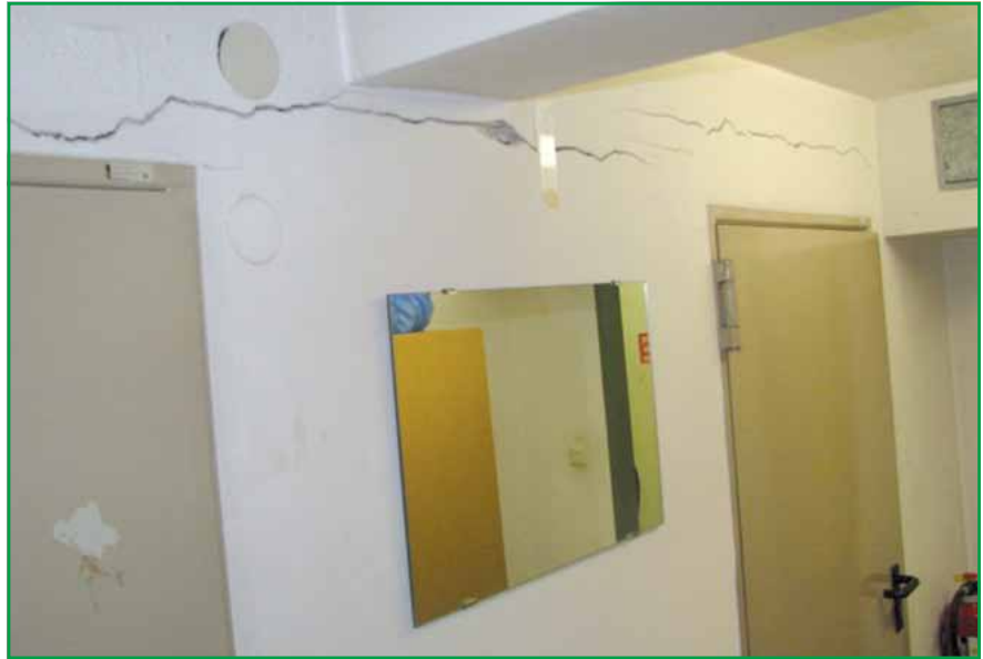
Deutliche Risse im Polizeipräsidium Offenbach im Bereich der Umkleideräume im Keller
