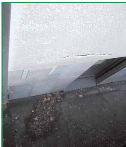
Riss in der Fassade im Hof und darunter abstehende Platten (Präsidium)
