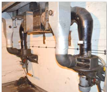
Noch funktionstüchtig: die originale Lüftungsanlage
