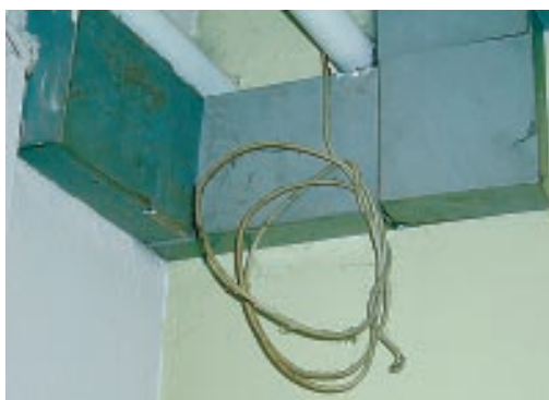
Verdrehte „fachmännisch“ verlegte Leitungen
