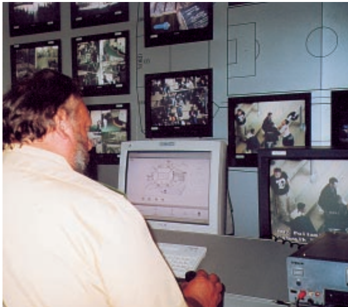
Hi-Tech-Befehlsstelle "Arena AufSchalke": 86 im Stadion montierte Kameras liefern den Beamten Bilder aus nahezu jedem Winkel des neuen Schalke Stadions. 16 Monitore in der Befehlsstelle sorgen für einen Gesamteindruck der Lage. Foto: Zielasko
